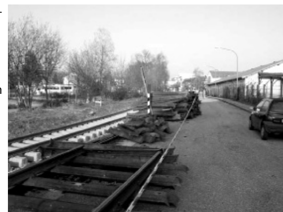
Deutlich zu sehen: die alten Gleise und Schwellen, die schon zum Teil über 100 Jahre alt sind.
