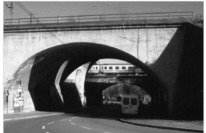
In der Unterführung Ehmannastraße gut sichtbar: Die Gleise verlaufen in zwei Ebenen. Die dritte Ebene (Gleise Richtung Bad Cannstatt) läge parallel zur hier sichtbaren Straße. Damit lassen sich die Fahrwege entwirren und das Gleiswinkel vor den Bahnsteigen vereinfachen.
