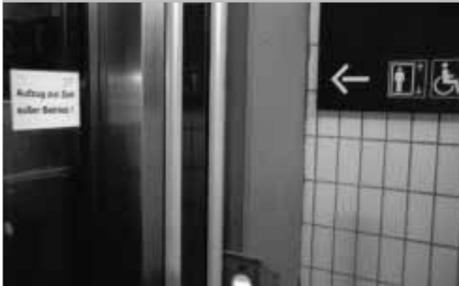
Auf dem Bahnsteig gefangen! Aufzüge sind immer wieder defekt.
