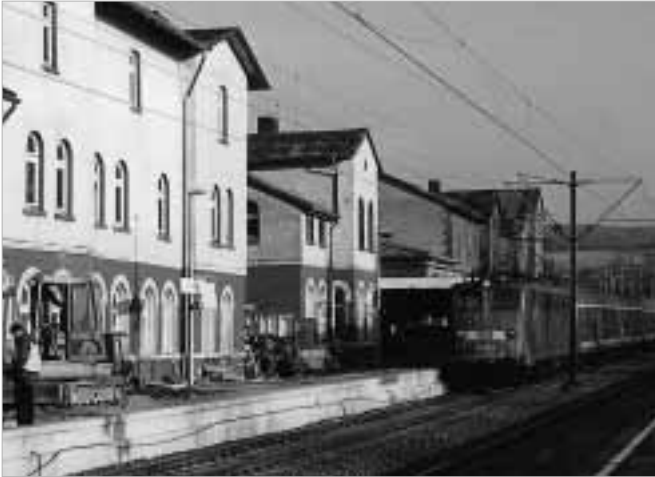
In aller Eile werden Bahnsteige für den ICE umgebaut, der dreimal täglich vorbeikommt. Altenbeken im November 2002.
